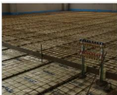
Particolare del tubo di riscaldamento
