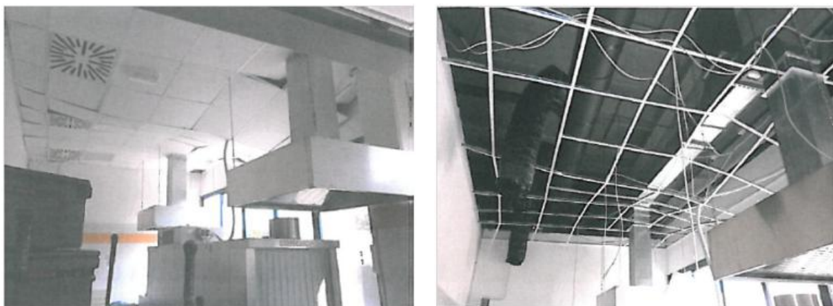
Cucina Controsoffitto aspirante
